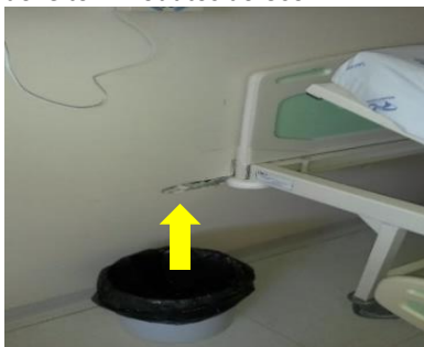
Figura 71 – Desgaste na parede atrás do leito – Produtos do Uso.
