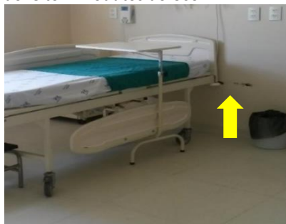
Figura 72 – Desgaste na parede atrás do leito – Produtos do Uso.
