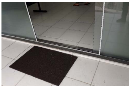
Figura 41 - Porta principal - desnível
