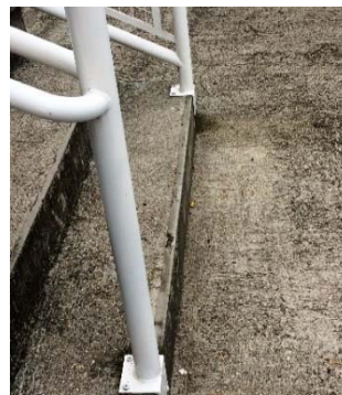
Figura 32 – Degrau escada sem sinalização
